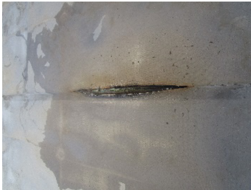
防水劣化状況
