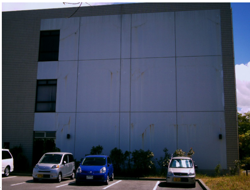
外壁劣化状況
