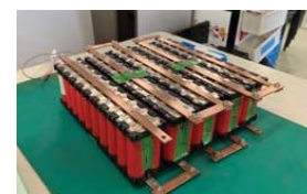
図6 組電池にしたバッテリー
