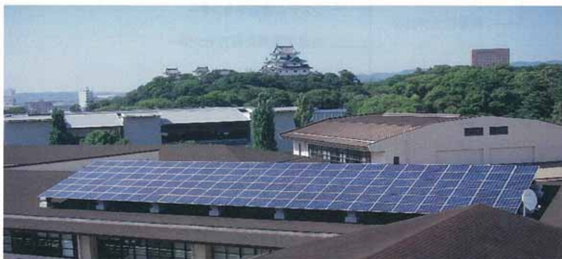
吹上団地(附属小・中学校),太陽光発電(太陽電池)容量:20kW
